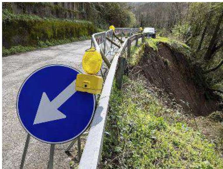
La strada provinciale 32 Nievole-Avaglio chiusa dall'ottobre 2023 per una frana
