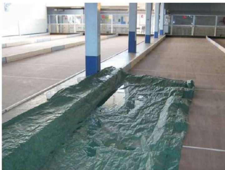
L'interno del bocciodromo di Montecatini in un'immagine scattata prima della sua chiusura con la pista di gioco coperta da un telo per far fronte alle infiltrazioni di acqua dal tetto
